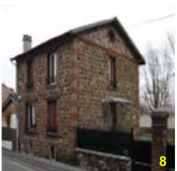
Appareillage « réglé » et joints beurrés qui donnent un rythme continu à la façade façon « nid d'abeilles »
