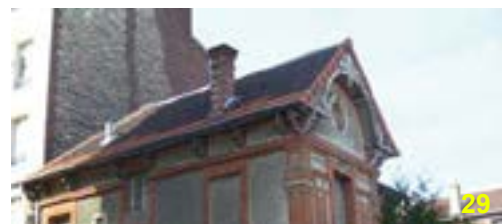
1 rue Désiré Lelay. Les tuiles de rive et celles au-dessus de la ligne d'égout ne sont pas de la même couleur que l'ensemble de la toiture
