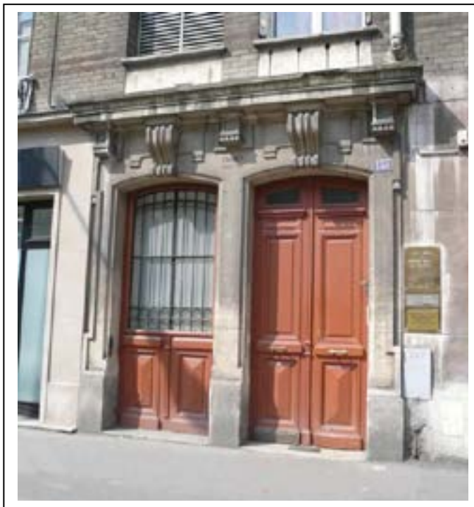
Porte d'entrée et ouverture de loge au 135 rue Gabriel Péri. Département de la Seine-Saint-Denis, DCPSL, SPC
