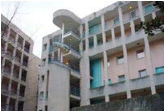
Salissures noires plus marquées aux endroits où ruisselle l'eau (au niveau des appuis par exemple)
