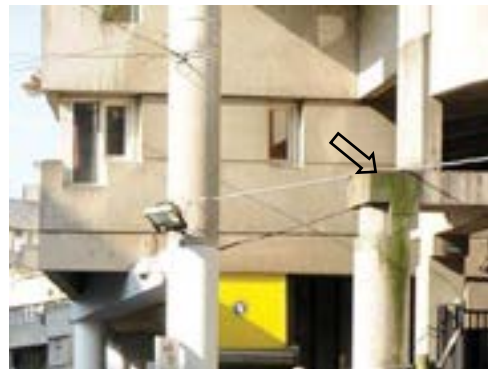
Colonisation végétale formant des salissures vertes en parement
