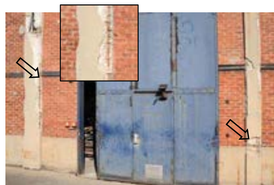
Eclatement du béton sous l'effet de la rouille (corrosion des armatures)
