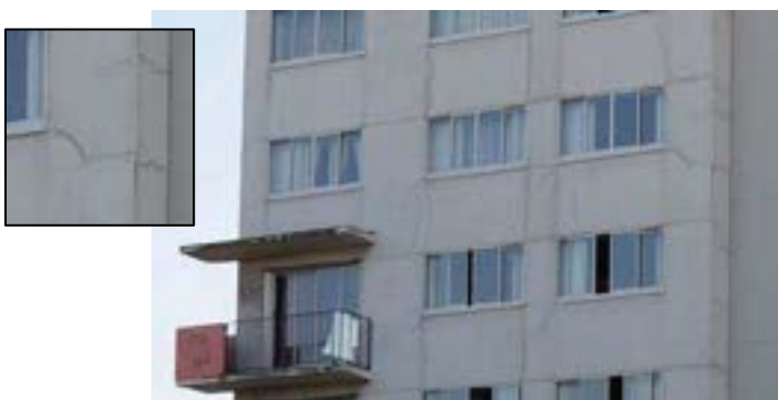
Fissures sur l'ensemble de la façade qui favorisent la pénétration d'agents pathogènes.
