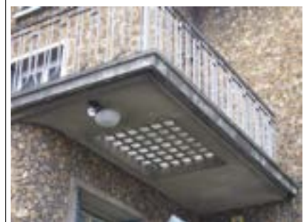
Détail de plancher de la terrasse avec incorporation de dalles de verre permettant l'éclairage doux et pratique
