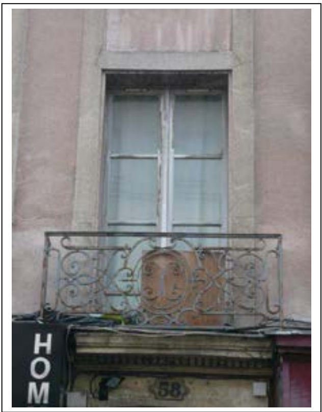
Détail du garde-corps ancien au-dessus de la porte d'entrée du 58 rue Gabriel Péri. Département de la Seine-Saint-Denis, DCPSL, SPC
