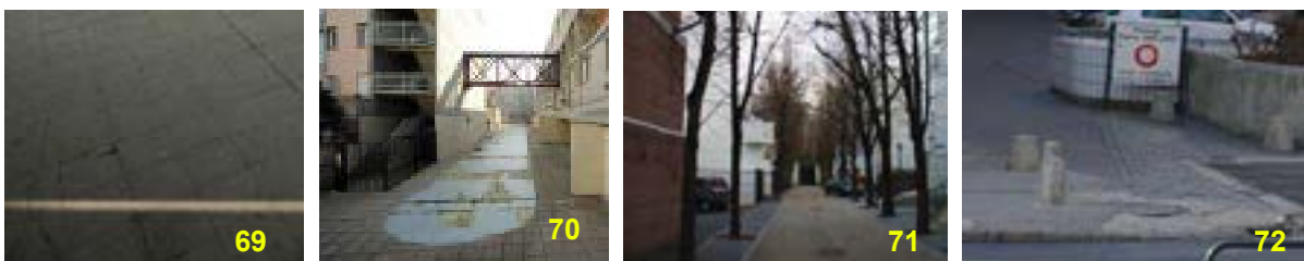
Les dalles en ciment se retrouvent à rez-de-voirie sur la place du Caquet et au niveau des dalles. Les fissures et éclats nuisent à la perception de l'espace.
