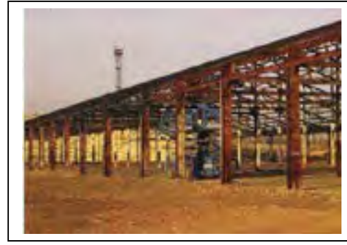
Structure extérieure mise à nu pour le chantier Département de la Seine-Saint-Denis, DCPSL, SPC
